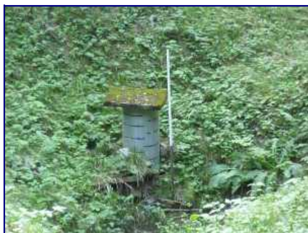
Un regard de visite pour contrôler le bon écoulement des eaux dans les canalisations souterraines.
