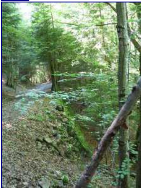
Mur en contrebas de la ligne, partiellement éboulé.
