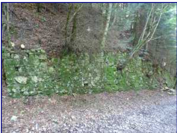
Mur de soutènement. La végétation reprend ses droits !
